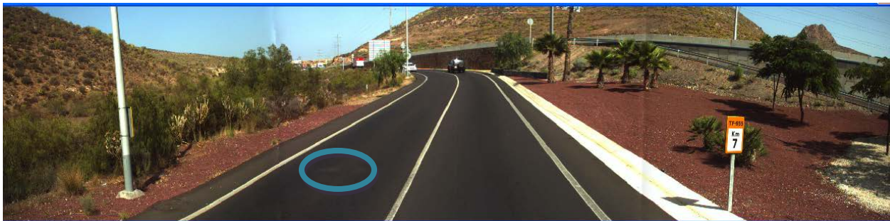
Imagen nº 1 Ubicación aproximada del socavón objeto de la afección, situado a la altura del Pk 7+000 de la TF-655.
