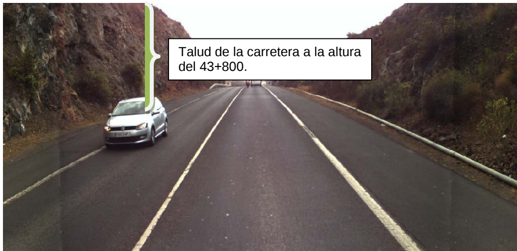
Imagen n° 1 Vista del lugar donde se produjo la supuesta incidencia Pk 43+800, en la que podemos observar el talud objeto de la afección.
