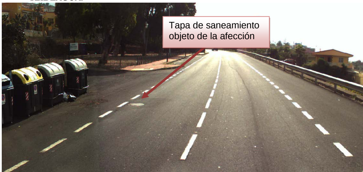
Imagen nº 1 Vista de la ubicación de la tapa de saneamiento objeto de la afección situada a la altura del Pk 5+230 margen izquierdo sentido ascendente de la TF-16.
